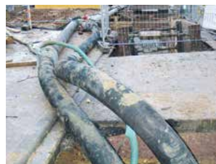
Knapp 400 m Rohrleitungen in DN 300 wurden im Bereich des Schachtes als flexible Gummispiral-Leitungen ausgelegt.
