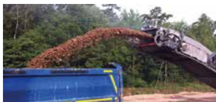
Der Materialstrom wird durch das Doppelband gebündelt und folgt einer definierten Flugbahn. (Foto: Wirtgen)
