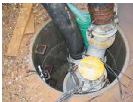
Standby: Solange der Abwasserkanal stillgelegt war, sicherten zwei Pumpen mit 54 kW Nennleistung und einer rechnerischen Leistung von jeweils 250 l/s das Bauvorhaben und bestehende Gebäude ab.
